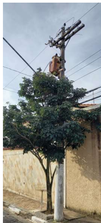
Plantio embaixo do transformador de energia
