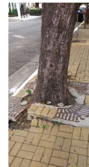
Utilização de gradil de solo sem levar em consideração os aspectos morfológicos da espécie. Notar que a árvore desconfigurou a calçada.
